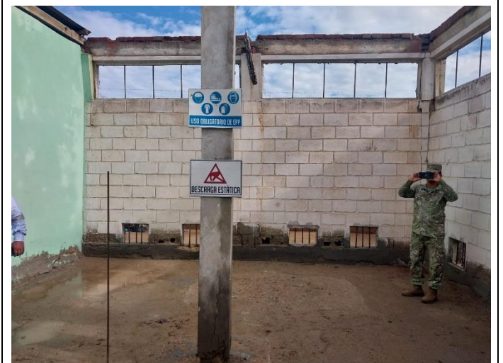
Tarrajeo intetior de muros y columna, reemplazo de ventanas, hacer piso semi pulido.
